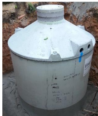
Eisspeicher im Erdreich neben dem Gebäude
