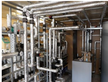
Technikzentrale mit Hydraulik, Wärmepumpe und MSR-Technik
