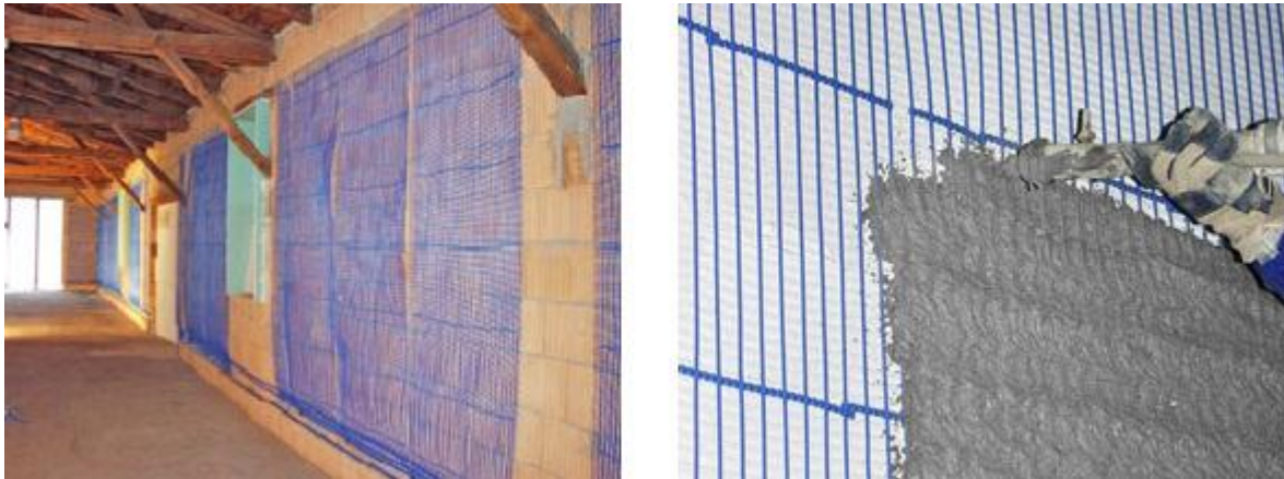
Abbildung 2: Flächen-Temperiersysteme des Herstellers Clina GmbH während der Wandanbringung (zur Heizung oder Kühlung)
