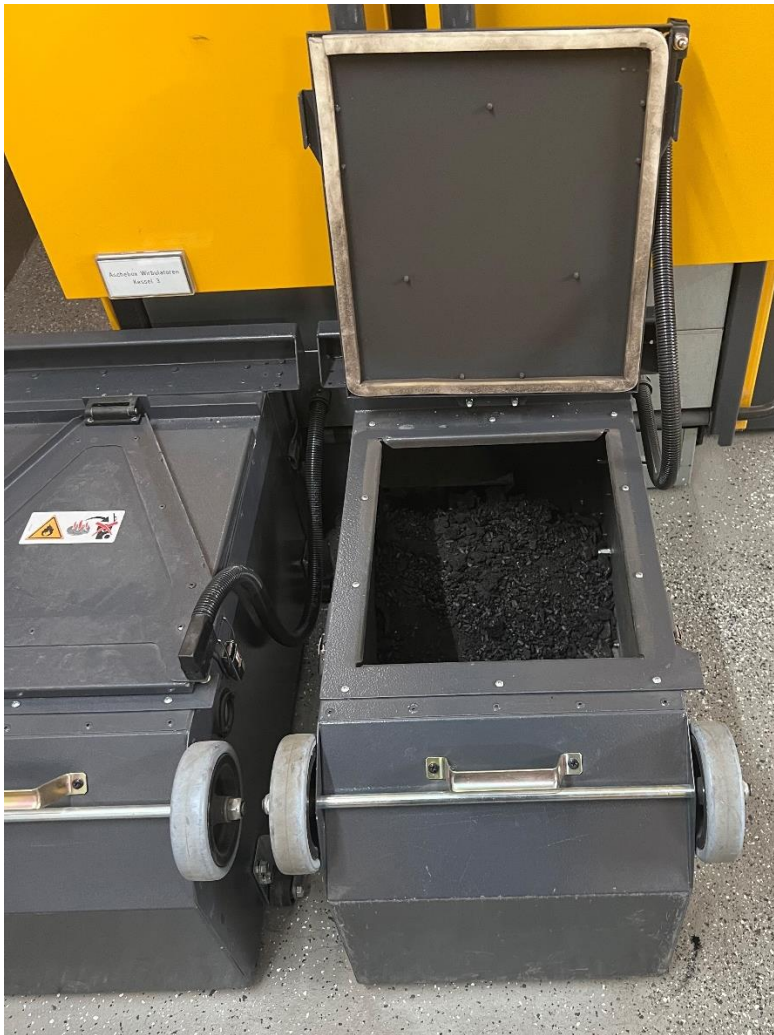
Abbildung 10: Aschebox im Heizhaus Schönberg Blick in den Pelletbunker im Heizhaus Schönberg; Quelle: Treurat und Partner
