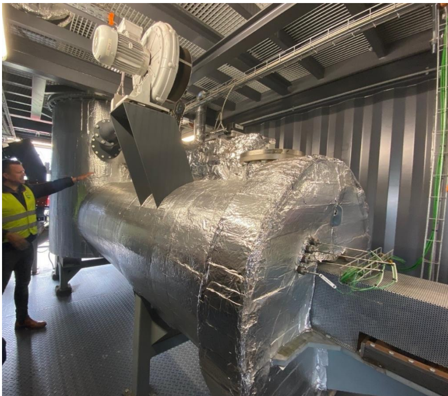
Abbildung 13: Biokohle-Reaktor Anlage, Quelle: Treurat und Partner
