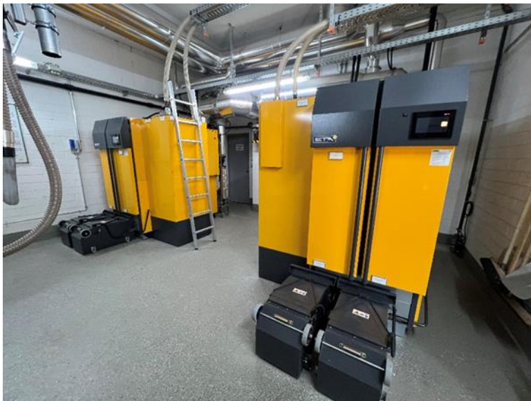
Abbildung 9: Pelletkessel im Heizhaus Schönberg; Quelle: Treurat und Partner
