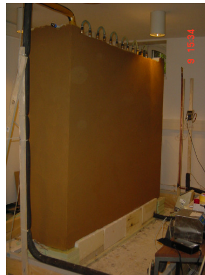
Abbildung 12: Dämmung und neuer Außenputz sind aufgebracht – danach werden die oberen Verbindungsrohre gedämmt
