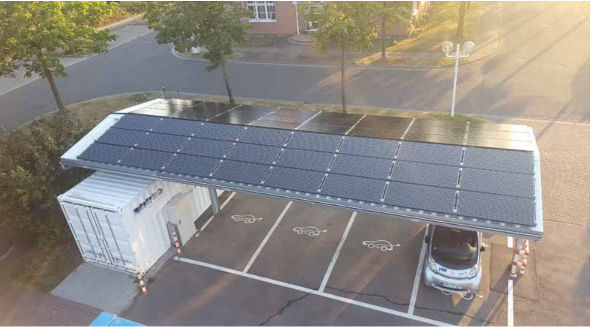
OptiCharge-Ladestation im InnovationsCampus Saar bestehend aus erneuerbarer Energiequelle in Form einer PV-Anlage, einer Vanadium-Redox-Flussbatterie (links im Bild) als Energiespeicher und insgesamt vier Ladepunkten für batterieelektrische Fahrzeuge. (Quelle: IZES)
